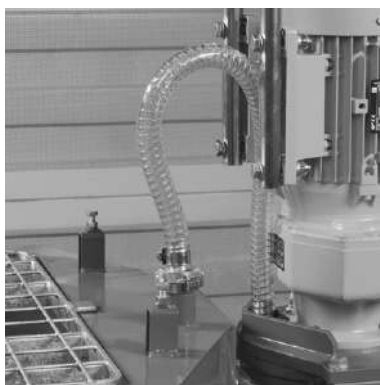
Figura 22: Mangueira de purga de ar
