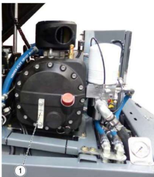
Figura 82: Verificação do nível de óleo através do visor
