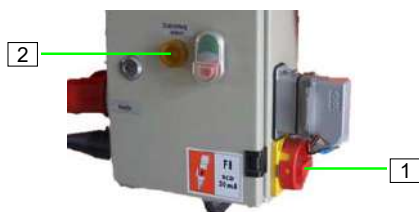
Figura 22: Verificando a direção de rotação
