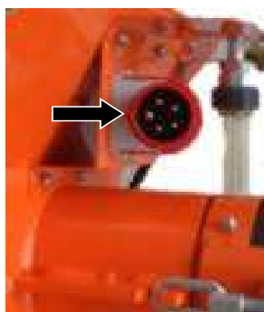
Figura 18: Conexão da fonte de energia
