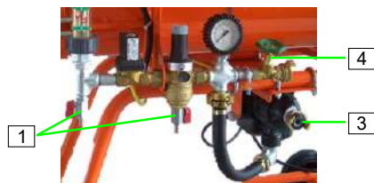
Figura 26: Conexão do abastecimento de água com bomba de reforço
