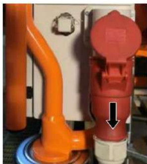
Figura 122: Remoção do cabo de conexão 400V
