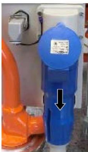
Figura 123: Remoção do cabo de conexão 230V
