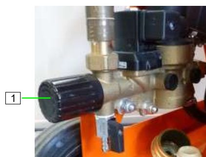
Figura 99: Válvula redutora de pressão
