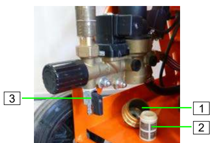
Figura 36: Verificando a tela de filtro para acoplamento
